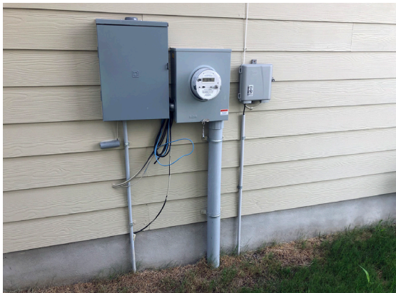
Líneas Subterráneas Conectadas a Medidor Eléctrico
